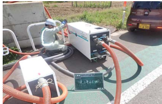
図3: 気水洗浄装置作動状況
