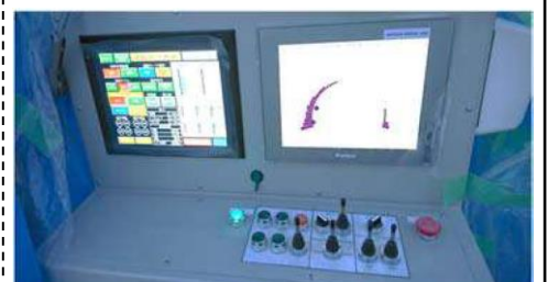
切削自動制御システム
