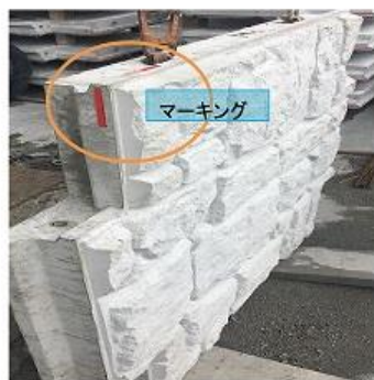
c) 変状サイン(マーキング)
