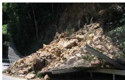
被災箇所の二次災害監視
