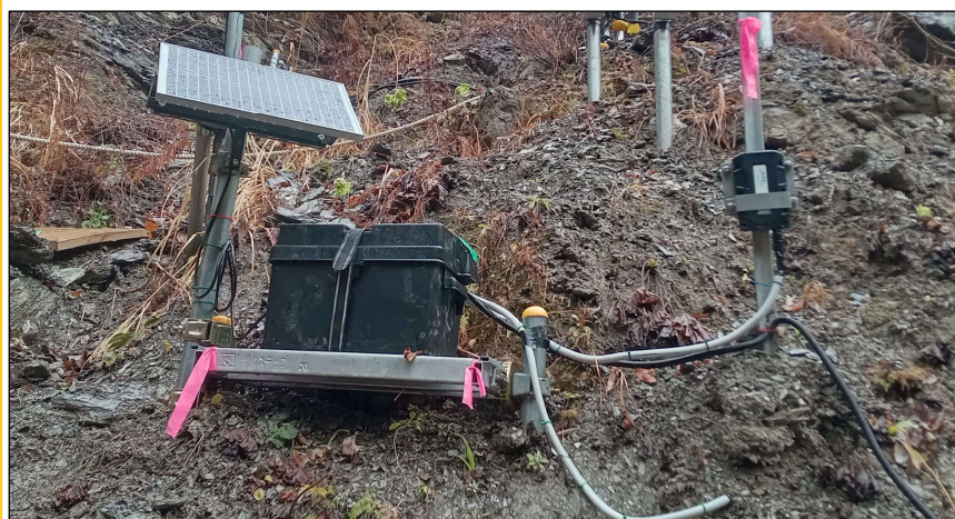
計測器設置状況
