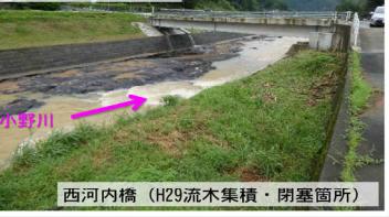
西河内橋（H29流木集積・閉塞箇所） 貯木地で捕捉されていた比較的巨大な流木については捕捉工下流側ではほとんど確認されていません。
