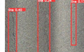
アスファルトひび割れ
