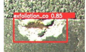
後打ちコンはく離
