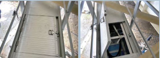
ケーブルラック点検扉
