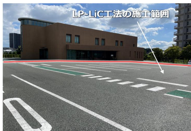
写真-2 LP-LiC工法施工地点の地震後の状況（令和8年熊本地震）
