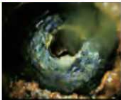
平成16年布設の中継ポンプ場 Φ150mm铸铁管
