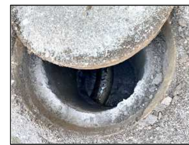
道路上 給水管上 No.92 (0.6 \text{m}^3/\text{h} ) 集合住宅汚水マンホールより漏水音
