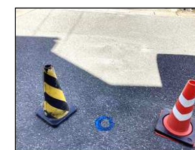
道路 分水栓 (1 \text{m}^3/\text{h} ) No.217 ポーリング作業後、漏水位置確定
