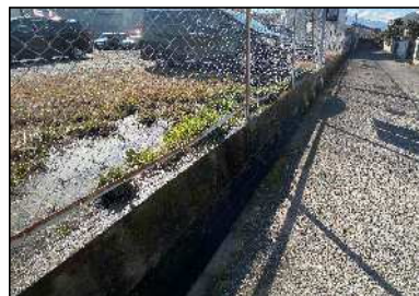
宅地内漏水 (0.6 \text{m}^3/\text{h} ) No.205 地上に流水
