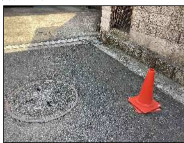
道路 給水管上 (0.6 \text{m}^3/\text{h} ) No.244
