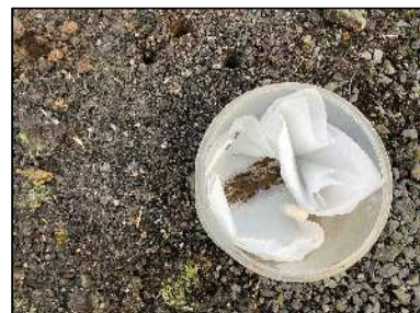
宅地内漏水 (0.006 \text{m}^3/\text{h} ) No.202 弁室手前で漏水
