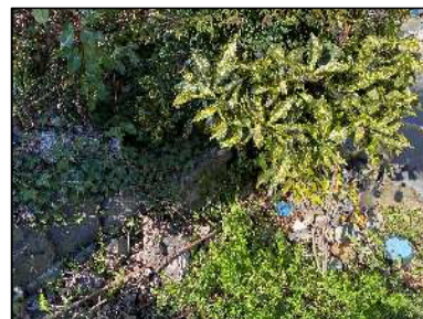
宅地内漏水 (0.6 \text{m}^3/\text{h} ) No.212 止水栓二次側で漏水
