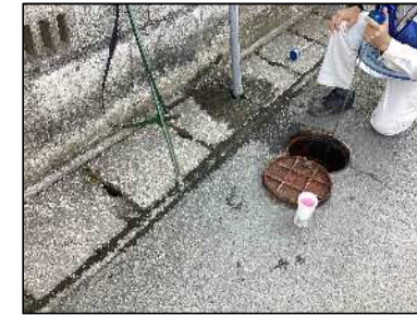
道路上 仕切弁 (0.03 \text{m}^3/\text{h} ) No.253
