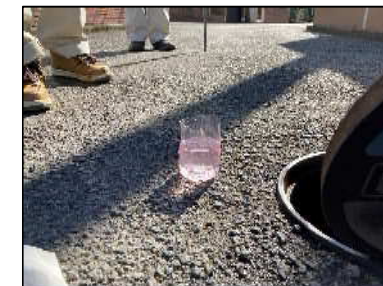
道路上 仕切弁 (0.03 \text{m}^3/\text{h} ) No.211 弁室に水。後日、塩素反応確認
