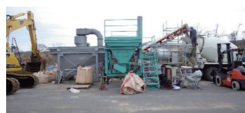
● 製造プラント(S + 4工法)
