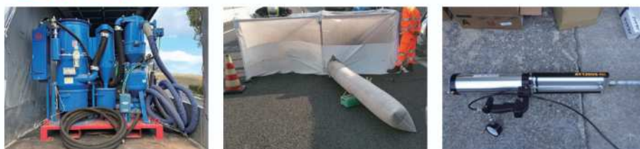
● バキュームプラスト装置
